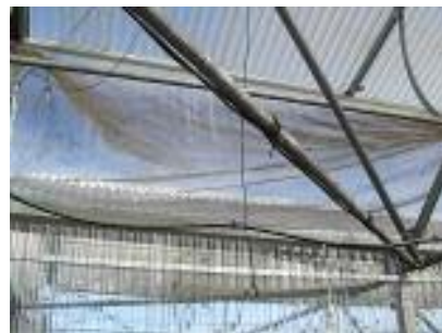
Mauvaise aération si ouvrant couvert d'insect-proof
